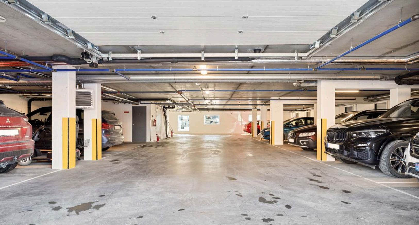
Felles oppvarmet garasjeanlegg i byggets 1. etasje.
