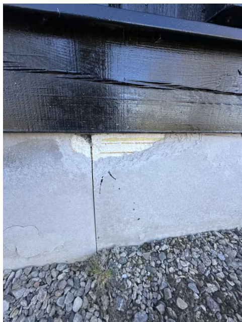
Viser avskalling ved grunnmursplate.
