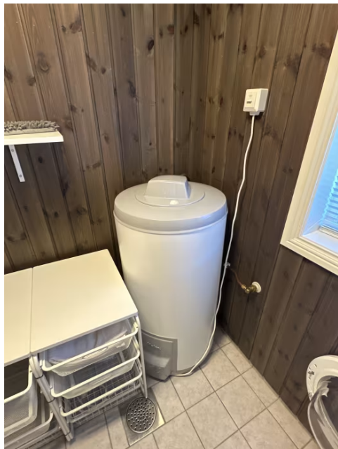
Viser Høiax bereder plassert på vaskerom.
