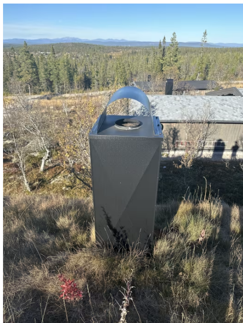
Viser pipe over tak.
