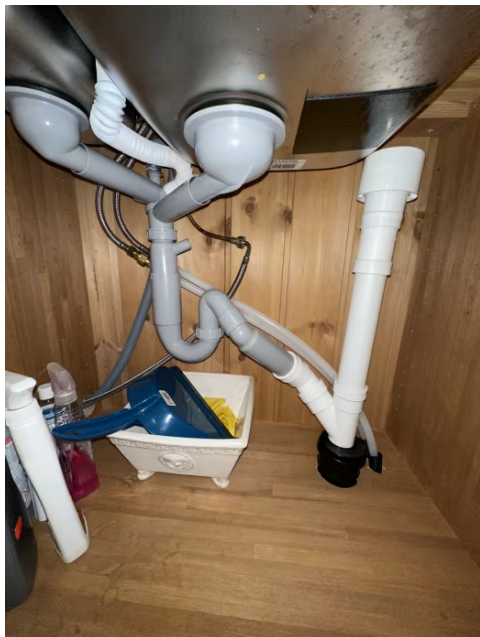
Viser vann og avløpinnstallasjoner
