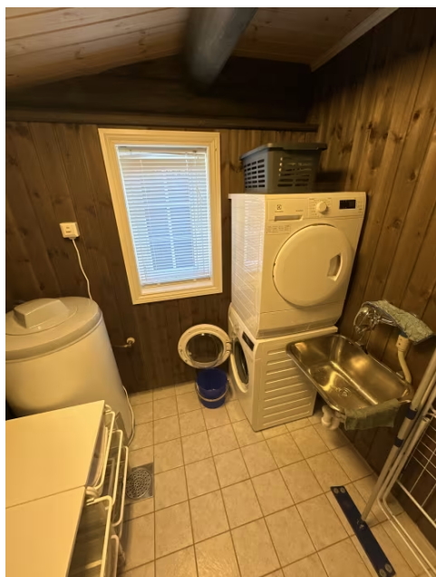
Viser installasjoner på vaskerom.
