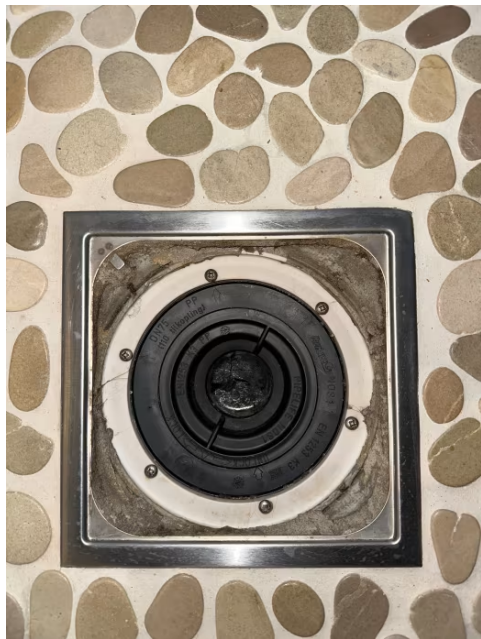
Viser sluk i dusjsonen.
