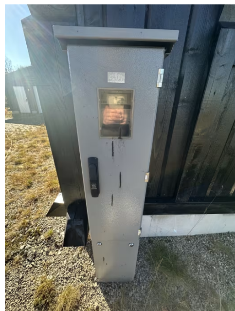
Viser utvendig inntakskap med måler. 400V
