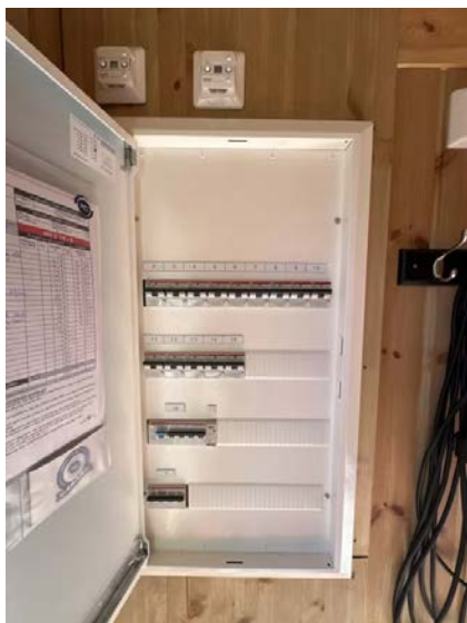
Viser innfelt sikringsskap plassert i bod med utvendig adkomst.
