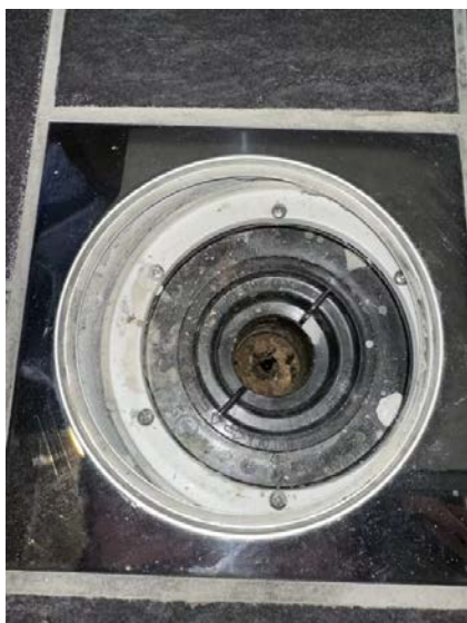
Viser sluk under innredning.
