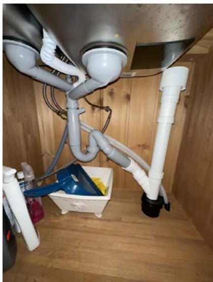
Viser vann og avløpinnstallasjoner
