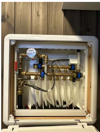
Viser innfelt fordelerskap, vanninntak, hovedstoppekran, varmekabel og vannmåler plassert på vaskerom.
