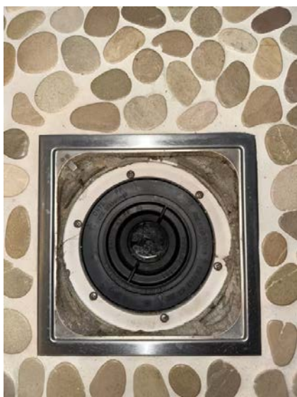
Viser sluk i dusjsonen.
