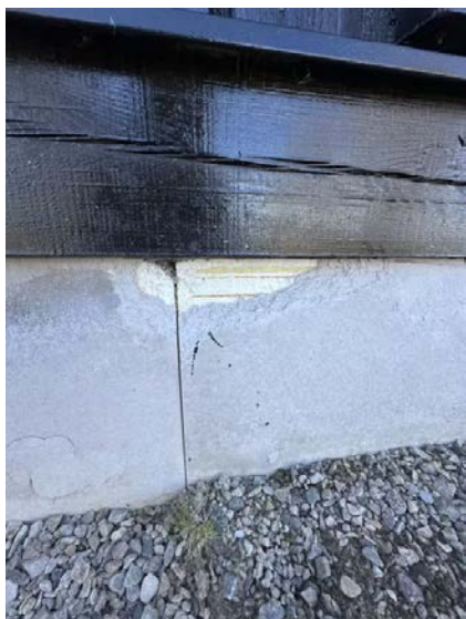
Viser avskalling ved grunnmursplate.
