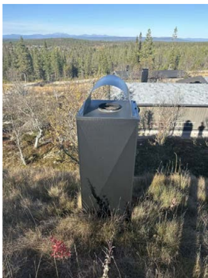
Viser pipe over tak.
