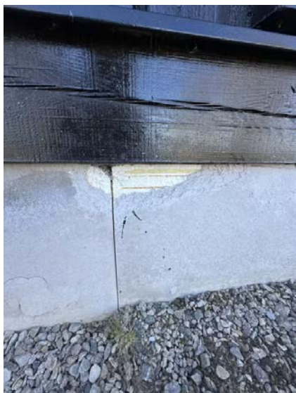
Viser avskalling ved grunnmursplate.
