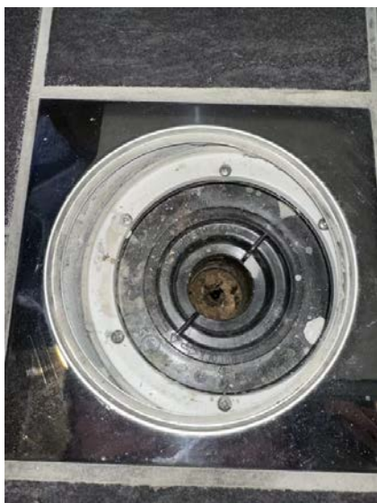
Viser sluk under innredning.
