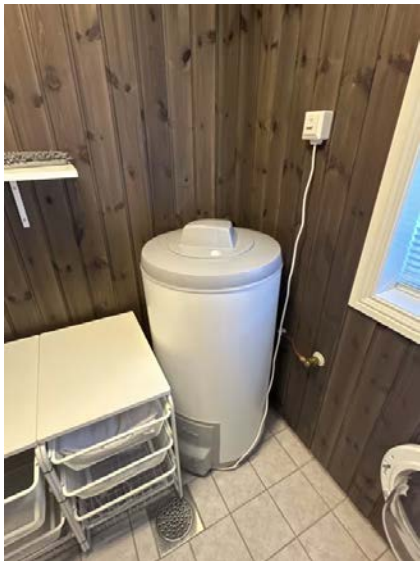
Viser Høiax bereder plassert på vaskerom.
