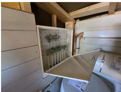
Skap til rør i rør system, her er også stoppekran til vann.
