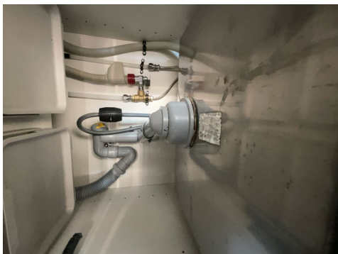
Del av rør til avløp.
