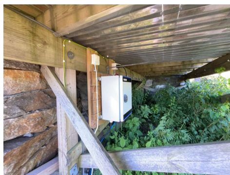
Styre skap til pumpe kum.
