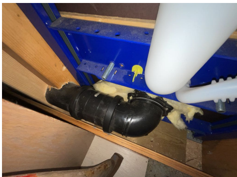
Del av rør til avløp.
