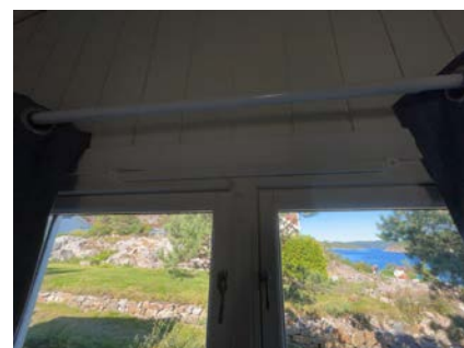
Eksempel på montert ventil i vindu.
