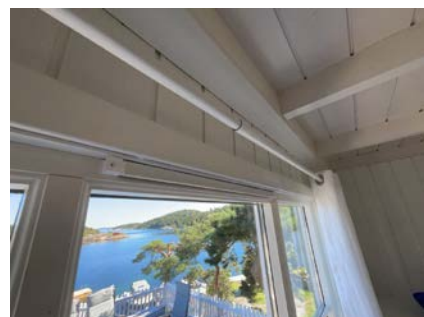
Eksempel på montert ventil i vindu.
