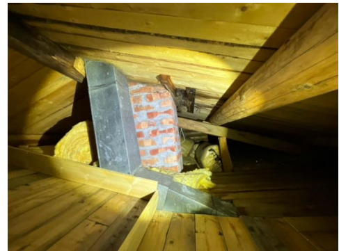
Innvendig påvist lekkasje
