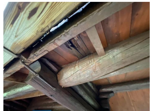
Lekkasje i svalgang
