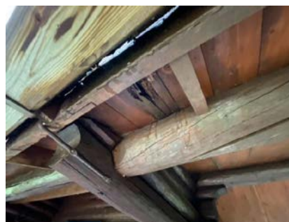
Lekkasje i svalgang
