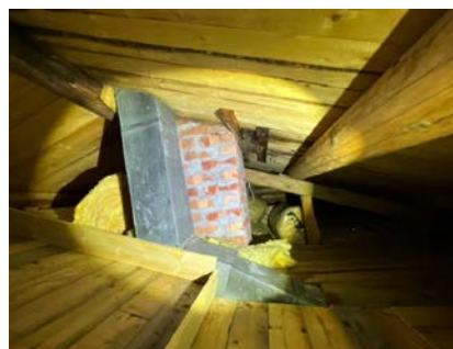
Innvendig påvist lekkasje
