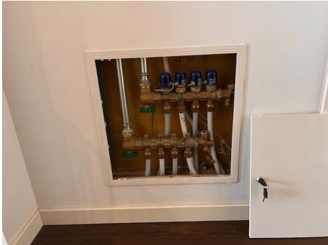
Fordelerskap for vannrør
