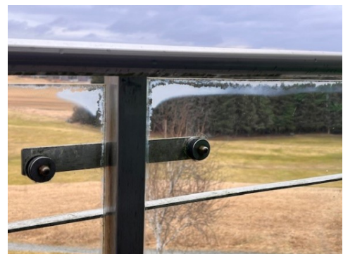
Fuktskade i glass
