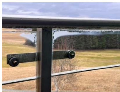
Fuktskade i glass
