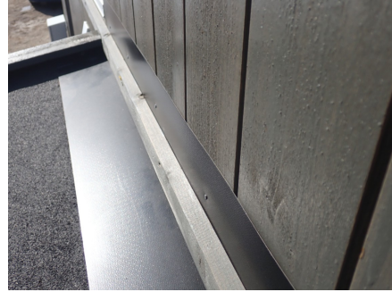
Bilde av beslagets utførelse mot kledning.
