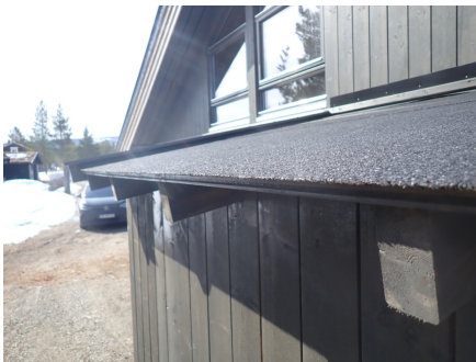
Det er ikke etablert renner/nedløp/beslag ved takfot.
