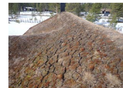
Bildet av torv med vedlikeholdsbehov.
