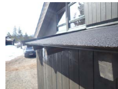
Det er ikke etablert renner/nedløp/beslag ved takfot.
