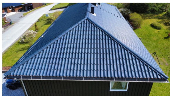
Takside mot nord/vest mangler snøfangere
