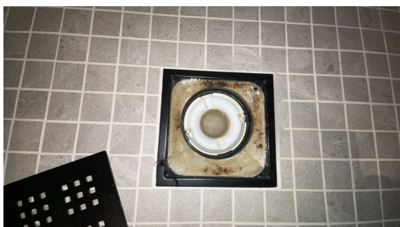
Sluk i dusj. Membran er synlig ved kontroll av klemring
