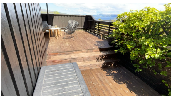
Trapp til veranda fra terrasse. Bør monteres håndløper ned langs trappen
