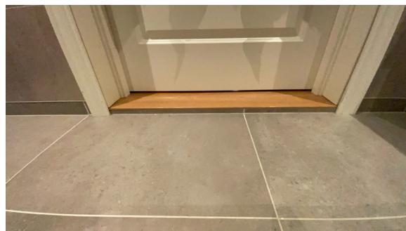
Tilluftsspalte under dør
