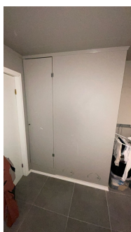
Piper og teknisk skap med varmtvannsbereder
