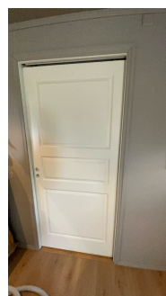
Skyvedør mellom kjøkken og hall m/trapp. Mindre overflateskade på dørblad
