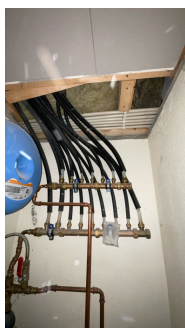
Vannfordelingskolber ligger åpent i teknisk rom
