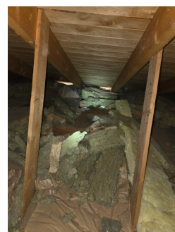
Er en del løs isolasjon som ligger ujevnt på loftet. Bør fordeles og legges jevnt utover for å sikre best mulig isolering
