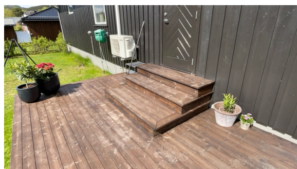
Det bør monteres håndløper for å øke personsikkerheten
