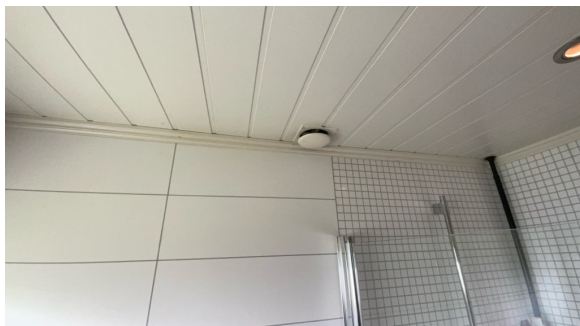
Avtreksventil i himling med avtrekksvifte på kryploft
