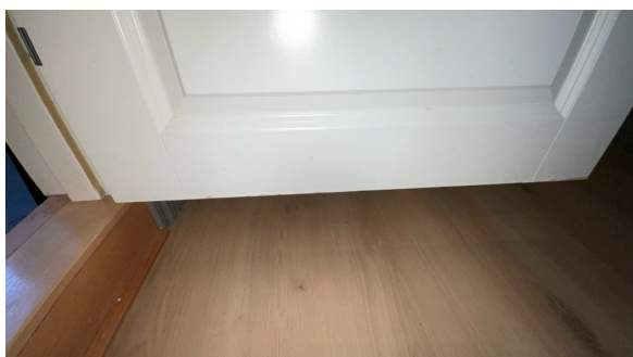
Fuktskade i nedre del av dør på bad
