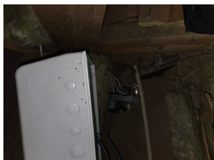
Spotter er montert med kasser, men kasser er ikke tette mot dampspærren.
