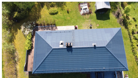
Oversikt tak og beslag. Mangler snøfangere på deler av taket
