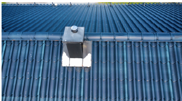
Luftehatt, noe avskalling av lakk
