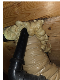
Skummet rundt avløpslufting og avtrekk på luftehatt
