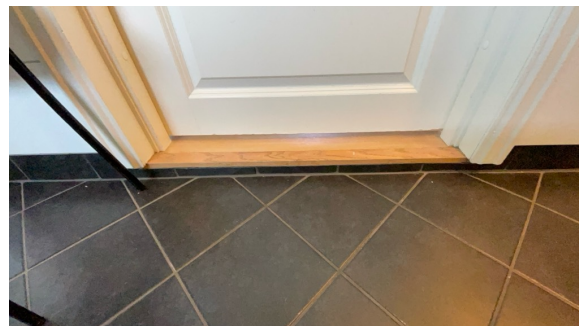
Tilluftsspalte under dør
