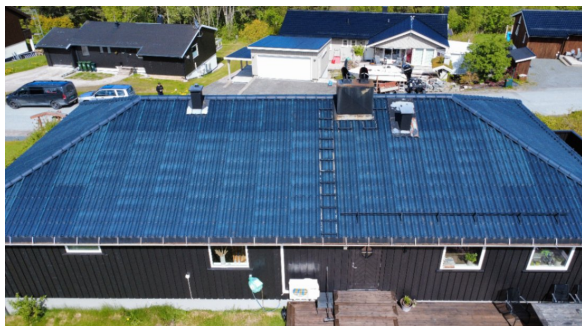
Takside mot sør/vest mangler snøfangere på deler av taket
