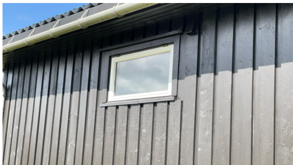
Vindu på bad fra 2010
