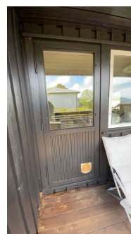
Verandadør med utgang fra stue. Tidligere katteluke er fjernet og tettet utvendig med plate etter beferingen
