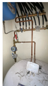
Hovedstoppekrane, vannmåler og vannstoppventil
