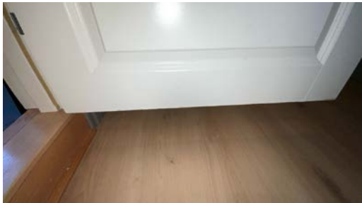
Fuktskade i nedre del av dør på bad
