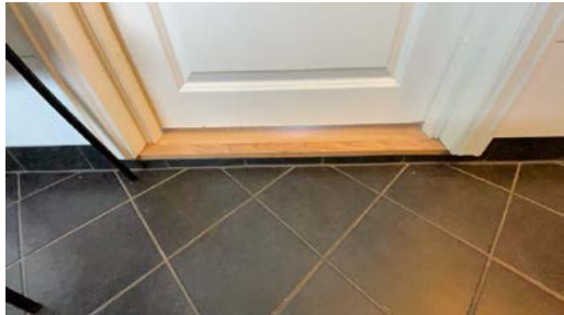
Tilluftsspalte under dør
