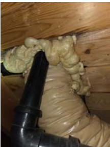
Skummet rundt avløpslufting og avtrekk på luftehatt
