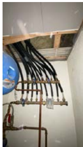
Vannfordelingskolber ligger åpent i teknisk rom
