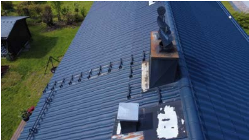
Luftehatt og pipebeslag med 2 hatter. Det er noe synlig rust og avskalling av lakk
