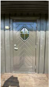
Dør ut til terrasse på oversiden av boligen. Etter befaringen er beslag under dør utbedret av selger
