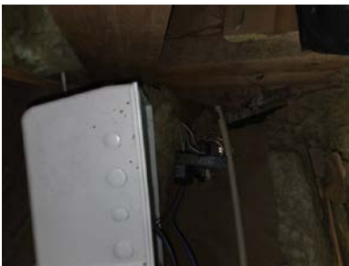
Spotter er montert med kasser, men kasser er ikke tette mot dampsperran.
