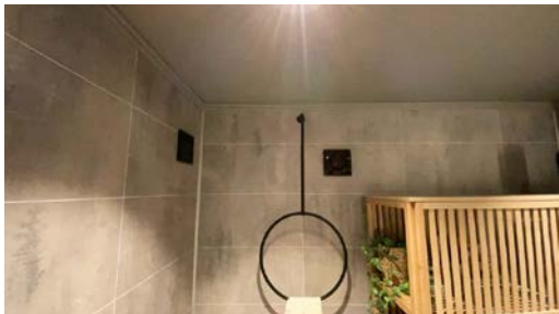
Mekanisk avtrekk på vegg
