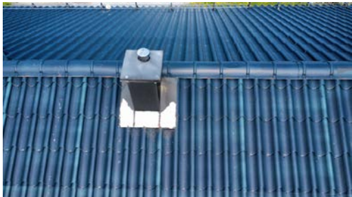
Luftehatt, noe avskalling av lakk
