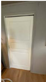
Skyvedør mellom kjøkken og hall m/trapp. Mindre overflateskade på dørblad
