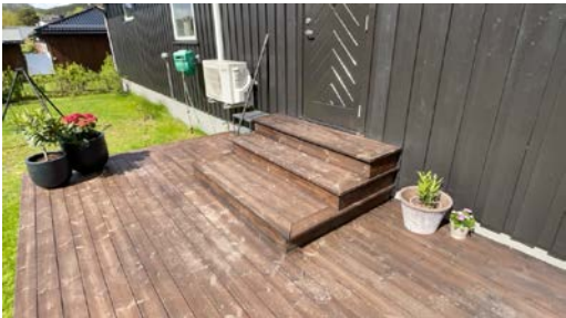
Det bør monteres håndløper for å øke personsikkerheten
