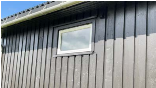
Vindu på bad fra 2010
