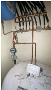
Hovedstoppekrane, vannmåler og vannstoppventil
