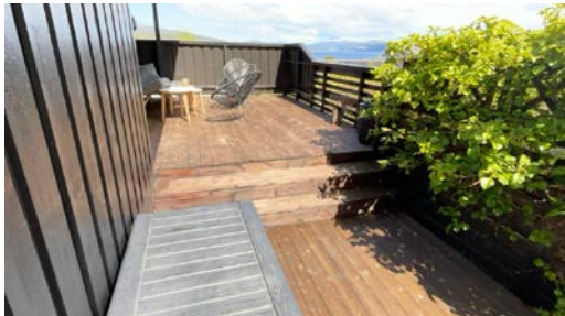
Trapp til veranda fra terrasse. Bør monteres håndløper ned langs trappen
