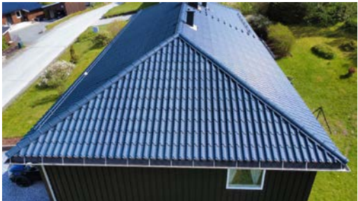
Takside mot nord/vest mangler snøfangere
