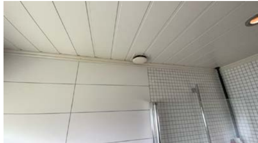
Avtreksventil i himling med avtrekksvifte på kryploft
