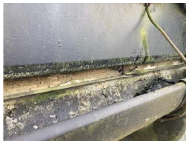
Forkantbeslag dekker ikke helt ned til takrenne.
