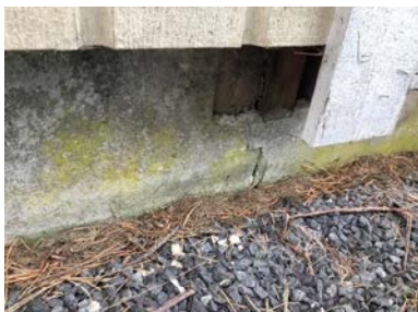
Eksempel på sprekk i grunnmur.
