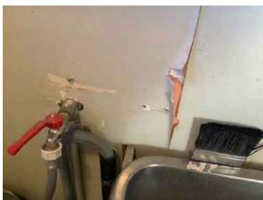
Skade på vegg ved vask.
