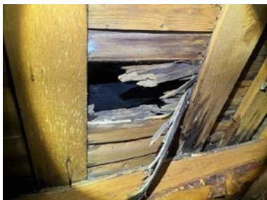
Råte i lekt ved pipe.
