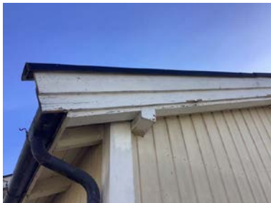
Eksempel på slitasje.
