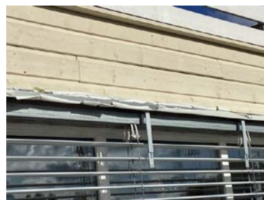
Eksempel på avskaling på beslag.
