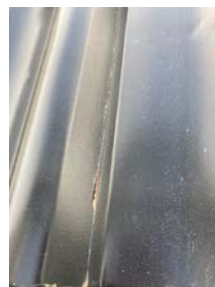
Eksempel på generell rustskade.
