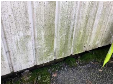
Området med lett begynnende råteskader.
