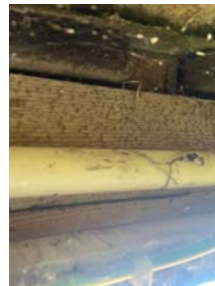
Utlekking av vegg sett fra undersiden. Utlekking er tilsynelatende påbegynt direkte på opprinnelig kledning, dette gir den eventuelle etterisoleringen en mer begrenset effekt.
