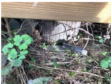
Råte i søyle for luftveranda.
