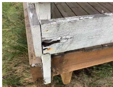
Råte på hovedveranda i 1. etasje.
