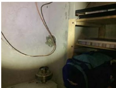
Provisorisk tetting i kjeller.
