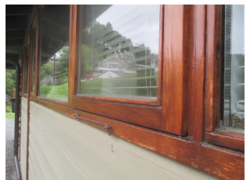
Godt vedlikeholdt på baksiden av boligen.
