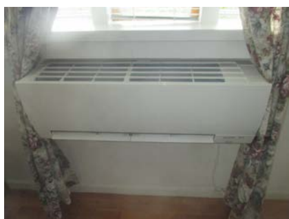
Varmepumpe i stue.
