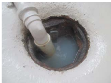
Eldre opprinnelig sluk.
