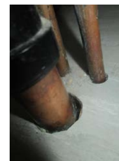
Rørgjennomføringer i gulvet.
