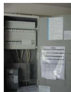
Sikringsskapet er plassert i trapperommet.
