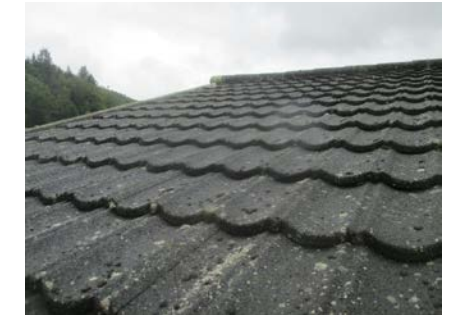
Har grodd noe mose på tekkingen.
