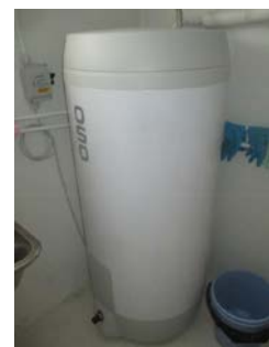
Nyere bereder er plassert på vaskerommet.
