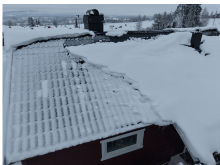
Det har gått takras fra deler av taket.
