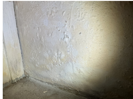
Salt/kalkutslag på kjellervegg.
