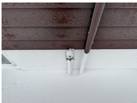
Påfyllingsrør til oljetank.
