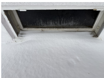
Varevindu mangler ytterdel.
