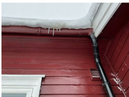
Tegn til lekkasje fra takrenne.
