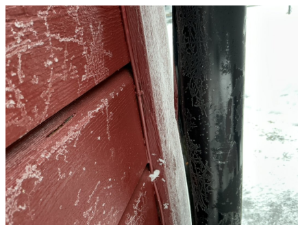
Buling i nedløpsrør.
