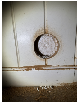
Det registreres plastisolasjon i utlektet veggkonstruksjon.
