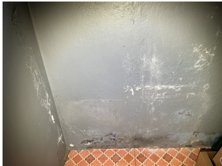
Salt/kalkutslag på kjellervegg.
