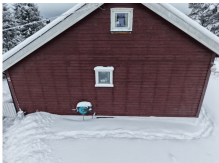
Symptomer på kuldebroer registreres på enkelte veggflater.
