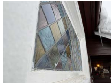
Skjevheter i blyglassvindu.
