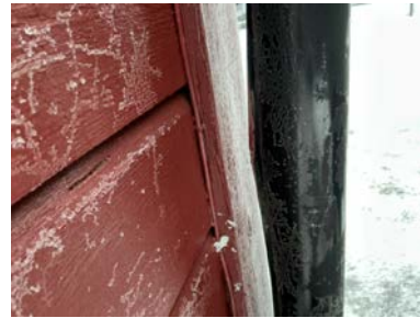
Buling i nedløpsrør.
