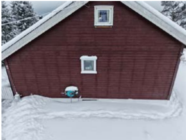
Symptomer på kuldebroer registreres på enkelte veggflater.
