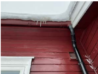
Tegn til lekkasje fra takrenne.
