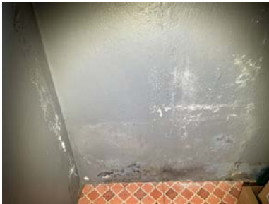
Salt/kalkutslag på kjellervegg.
