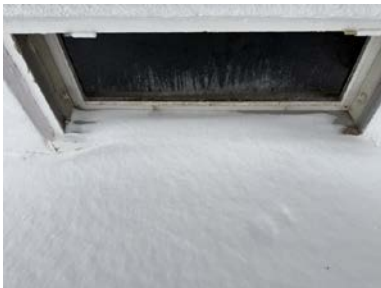
Varevindu mangler ytterdel.
