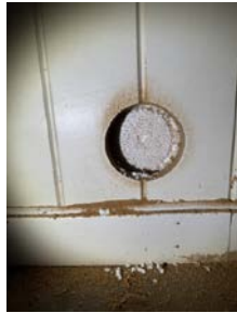
Det registreres plastisolasjon i utlektet veggkonstruksjon.
