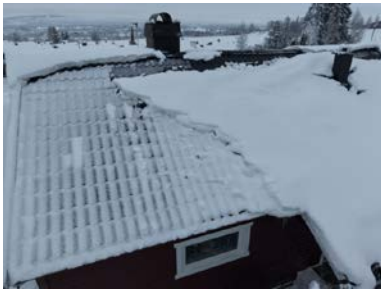
Det har gått takras fra deler av taket.
