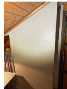
Riss og avflasket maling på pipe i loftsetasje.
