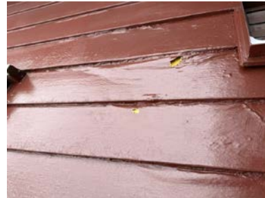
Malingsbobler og avflaset maling.
