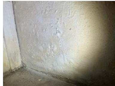
Salt/kalkutslag på kjellervegg.
