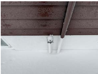
Påfyllingsrør til oljetank.
