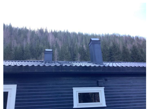
Bildet viser at det bare er adkomst til en pipe for feier.
