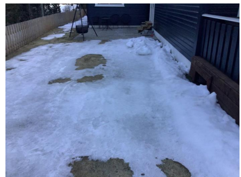
Bildet viser at det ikke er tilfredsstillende fall fra bolig.
