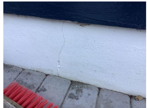
Bildet viser eksempel på utvendig skråriss.
