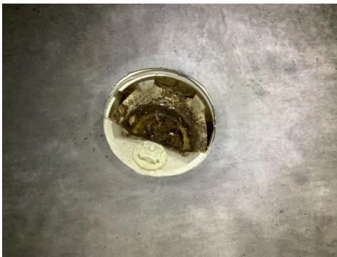
Bildet viser plastsluk, og at det ikke er tett tilslutning mellom plastsluk og tettesjikt.
