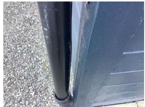
Bildet viser frostsprengt nedløpsrør.
