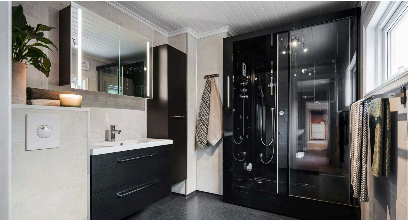
Badet i første etasje er gulvbelegg med gulvvarme og baderomsplater på veggene. Elektrisk styrt vifte.
