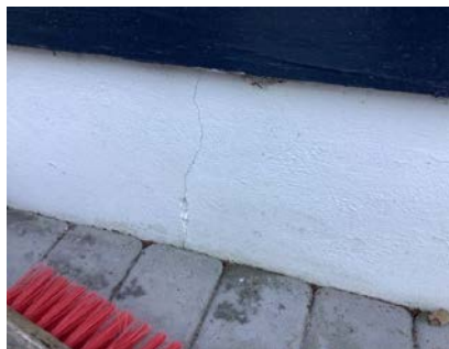
Bildet viser eksempel på utvendig skråriss.
