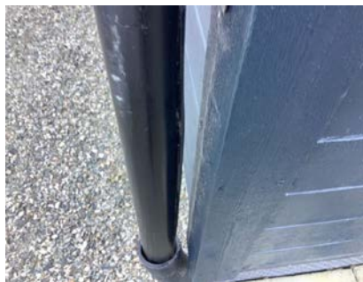
Bildet viser frostsprengt nedløpsrør.
