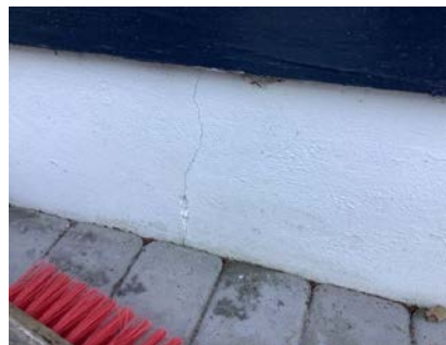
Bildet viser eksempel på utvendig skråriss.
