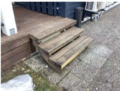
Bildet viser at det ikke er montert rekkverk på tretrapp.
