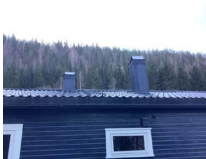
Bildet viser at det bare er adkomst til en pipe for feier.
