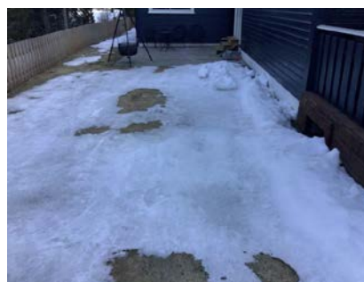
Bildet viser at det ikke er tilfredsstillende fall fra bolig.
