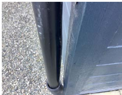
Bildet viser frostsprengt nedløpsrør.
