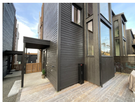
Noe nært terrenget på deler av kledningen.
