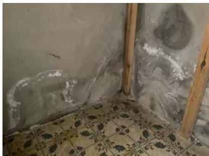
Saltutslag grunnmur innvendig
