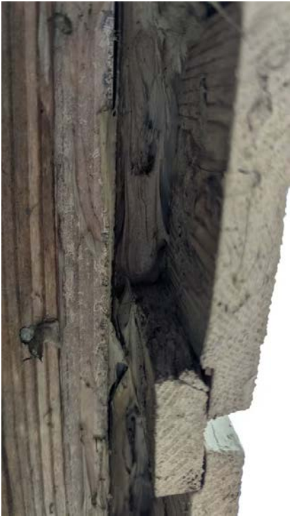
Lufting til karnapp er tett med fugemasse.
