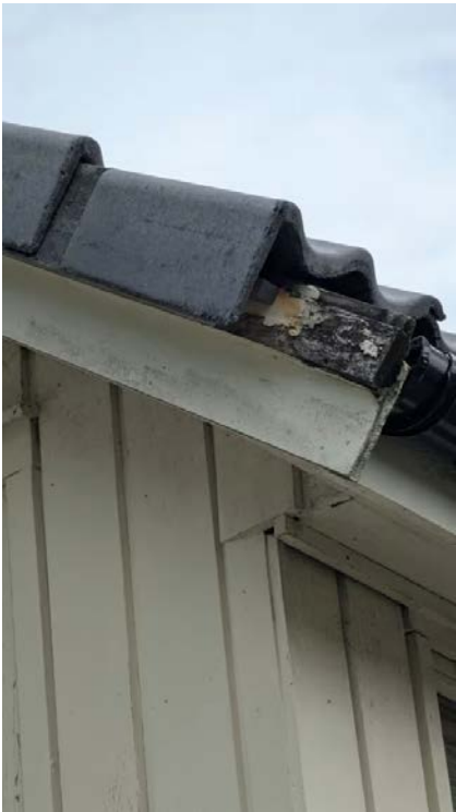
Nedbrytning/misfarging i vindski
