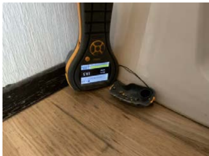
Fuktmåling i gulv ved toalett, det er tegn til fukt i parkett.
