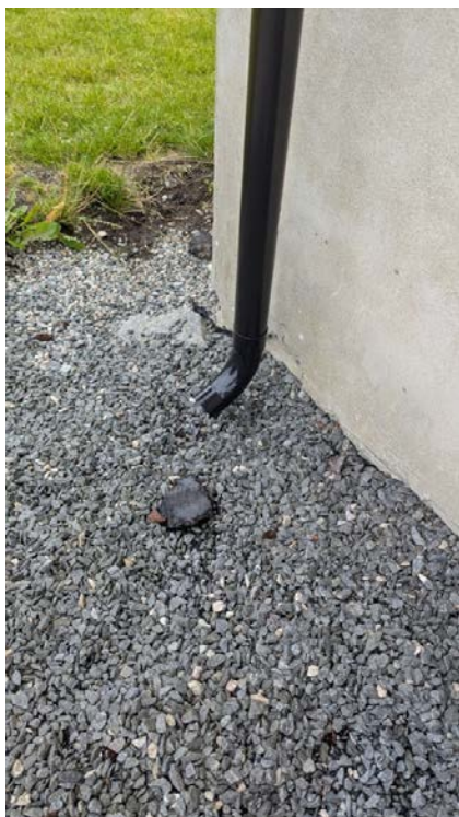
Nedløpsrør er ikke tilkoblet rør i bakken.
