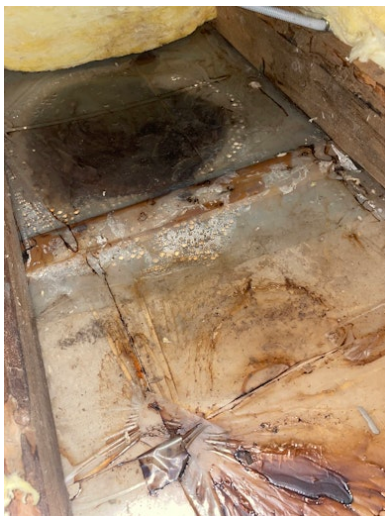
Under balkong, vannråper under dampsperre.
