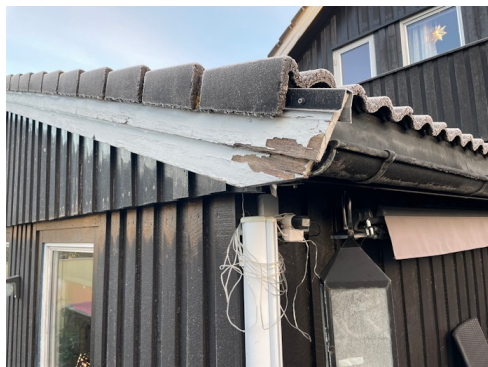
Vindskier med flassende maling
