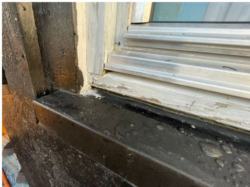
Slitasje vindu utvendig
