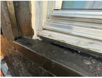
Slitasje vindu utvendig
