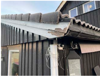
Vindskier med flassende maling
