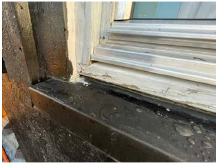
Slitasje vindu utvendig
