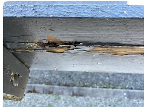
Begynnende råte i bord på terrasse.
