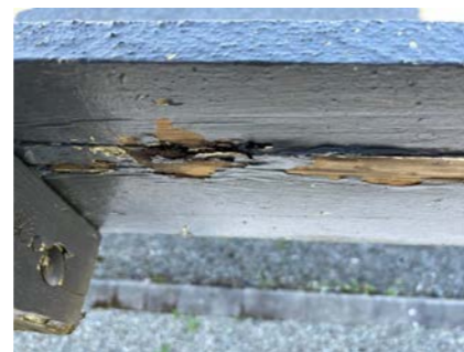
Begynnende råte i bord på terrasse.
