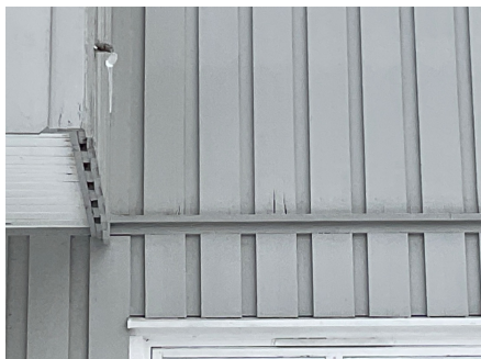
Kledning med begynnende råte.
