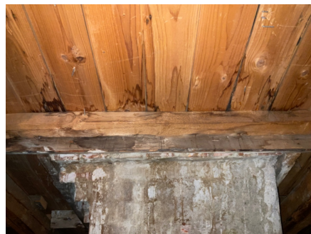
Fuktskjolder rundt pipe.
