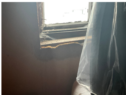
Vindu på loft med fuktskjolder.
