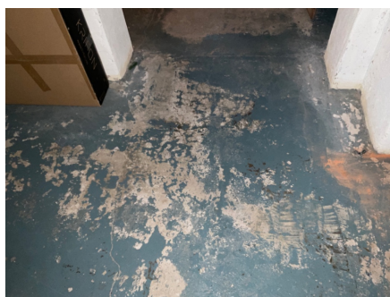
Fuktskjolder/saltutslag på gulv i kjeller.
