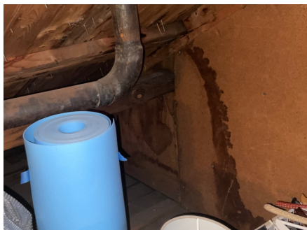
Fuktskjolder på vegg.
