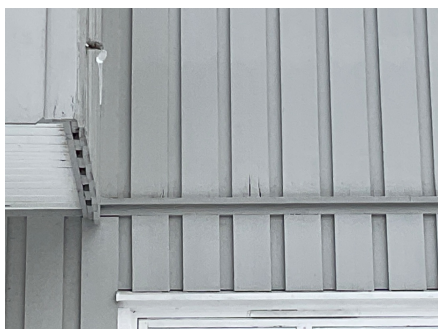
Kledning med begynnende råte.
