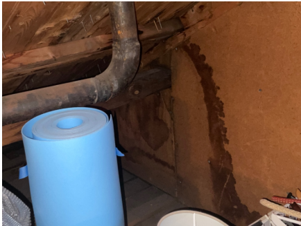
Fuktskjolder på vegg.
