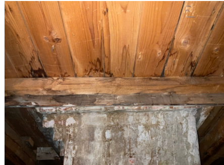
Fuktskjolder rundt pipe.
