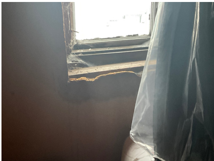
Vindu på loft med fuktskjolder.
