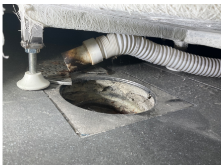
Sluk under dusjkabinett.
