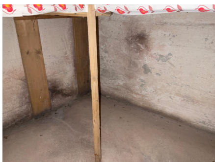
Fuktskjolder på vegg i kjeller.
