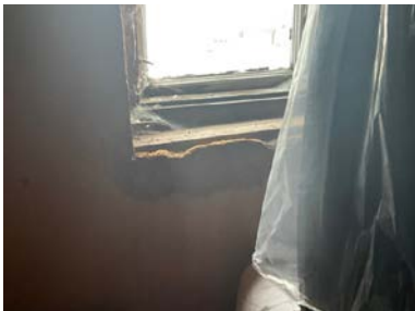
Vindu på loft med fuktskjolder.
