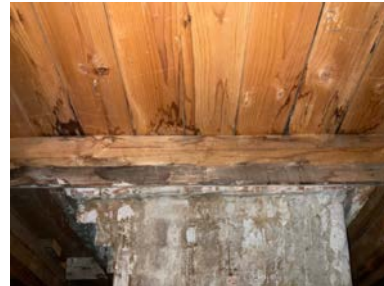
Fuktskjolder rundt pipe.
