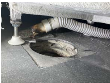
Sluk under dusjkabinett.
