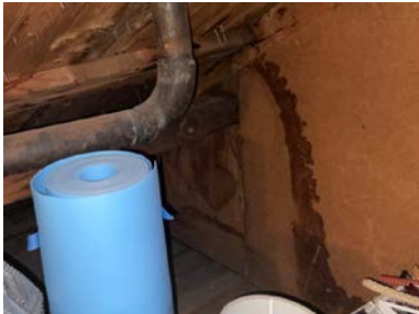
Fuktskjolder på vegg.
