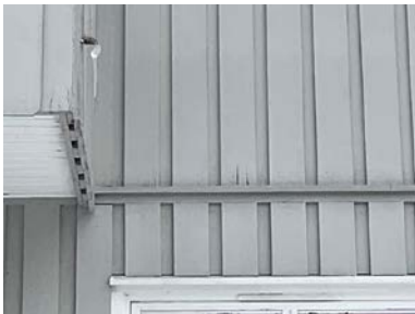
Kledning med begynnende råte.
