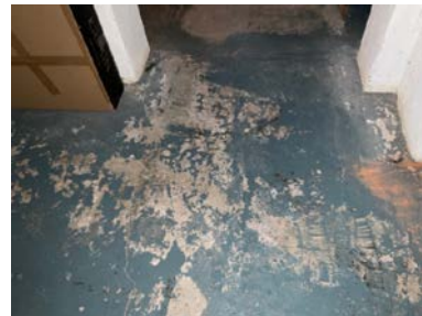
Fuktskjolder/saltutslag på gulv i kjeller.
