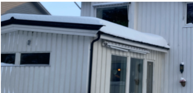
Manglende snøfangere på tilbygg mot vest
