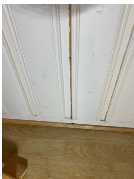
Tørkesprekk veggpanel, kjeller.
