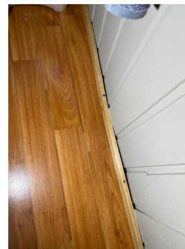
Skjevheter i veggpanel, loftsetasje.
