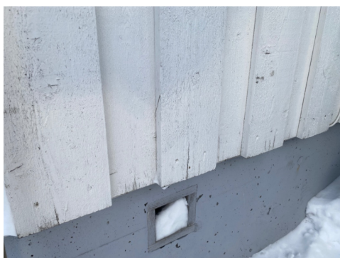
Stedvis sprukket og værslitt kledning
