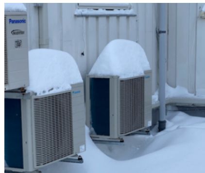
Varmepumpe utvendig del.
