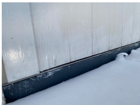
Værslitt overflate dør 1. Etg.
