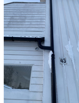
Manglende tilkobling av nedløpsrør.
