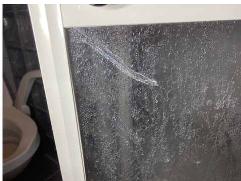
Sprekk i dør til dusj
