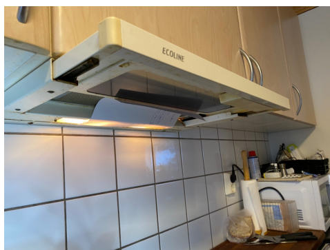
Funksjonstest av ventilator.
