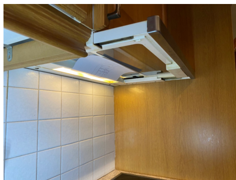
Funksjonstest av ventilator.
