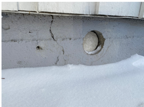
Sprekk i mur, manglende tetting av hullboring
