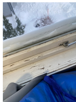
Malingsavlassing på foringer/karm. Vindu soverom i 2. etg
