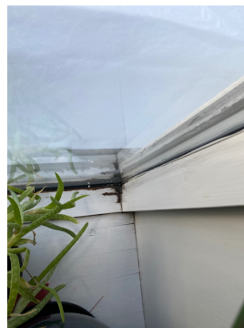
Missfarging fra kondens, stuevindu 2. etg
