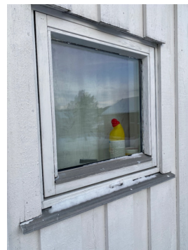
Manglende beslag over vinduer.
