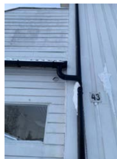
Manglende tilkobling av nedløpsrør.
