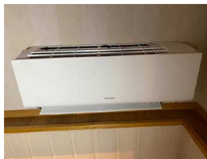
Varmepumpe innvendig del. Levert og montert av PTG AS.
