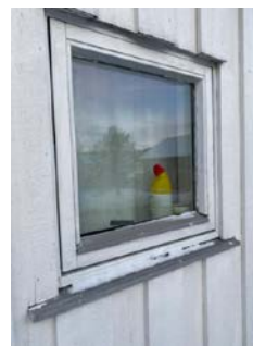
Manglende beslag over vinduer.
