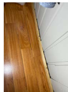
Skjevheter i veggpanel, loftsetasje.
