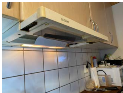
Funksjonstest av ventilator.
