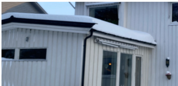
Manglende snøfangere på tilbygg mot vest
