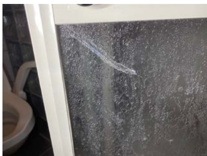
Sprekk i dør til dusj
