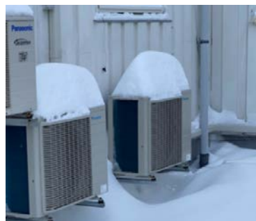
Varmepumpe utvendig del.
