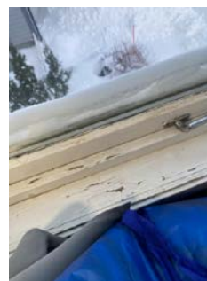
Malingsavlassing på foringer/karm. Vindu soverom i 2. etg
