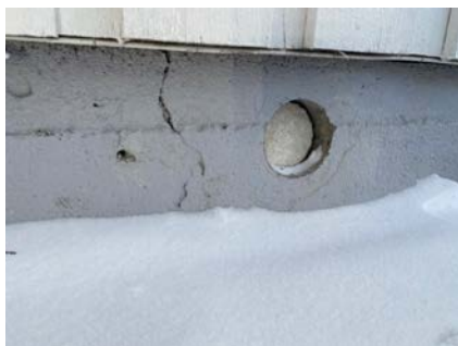
Sprekk i mur, manglende tetting av hullboring
