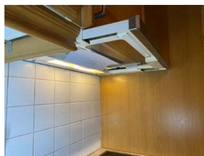
Funksjonstest av ventilator.
