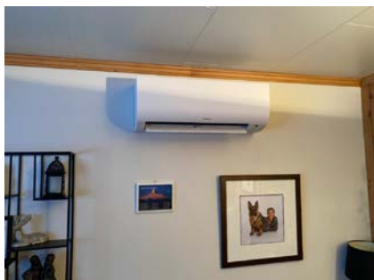
Varmepumpe innvendig del. Levert og montert av PTG AS.
