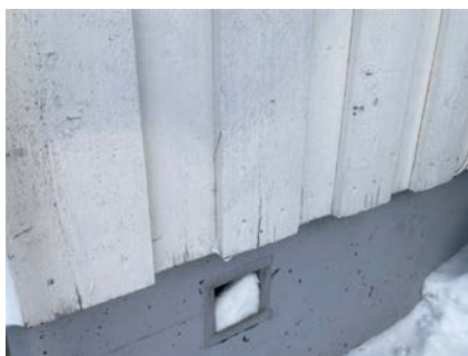
Stedvis sprukket og værslitt kledning
