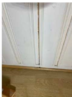
Tørkesprekk veggpanel, kjeller.
