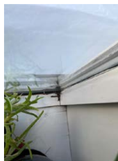
Missfarging fra kondens, stuevindu 2. etg
