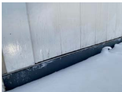
Værslitt overflate dør 1. Etg.
