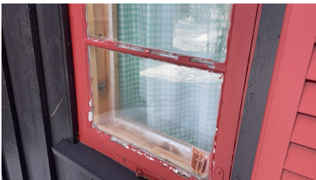
Må påregnes vedlikehold/utskifting
