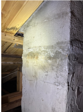
Fuktskolder med mugg på undertak og saltutslag på pipe
