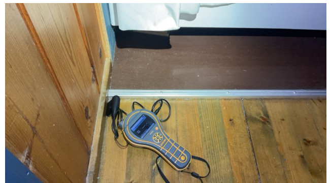
Ved fuktmåletaking av overgang vegg inne på badet er det ikke fuktutslag
