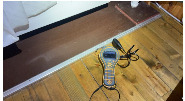
Ved fuktmåletaking av gulv inne på badet er det ikke fuktutslag
