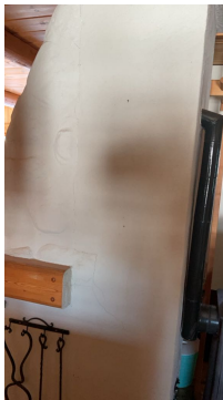
Riss/sprekkdannelse i pipe og til overgang peis
