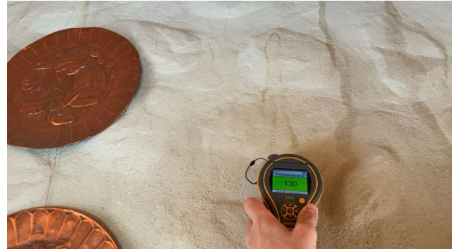
Bed fuktmåletaking var det ikke fuktutslag
