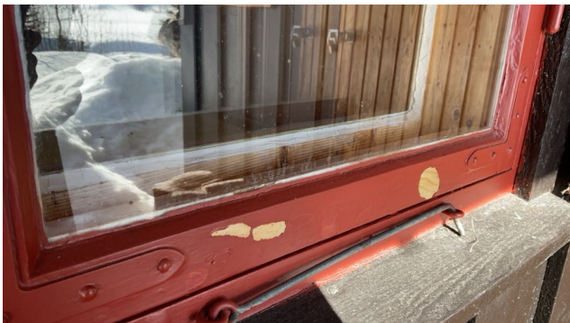
Vedlikeholdsbehov og sprekkdannelse i kitt
