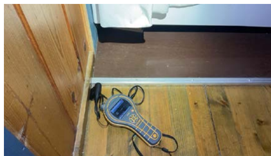
Ved fuktmåletaking av overgang vegg inne på badet er det ikke fuktutslag
