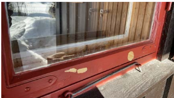
Vedlikeholdsbehov og sprekkdannelse i kitt
