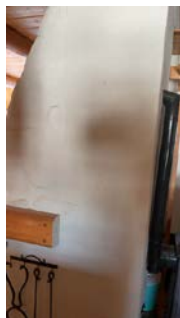
Riss/sprekkdannelse i pipe og til overgang peis
