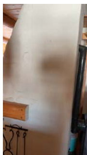
Riss/sprekkdannelse i pipe og til overgang peis
