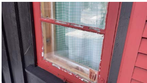
Må påregnes vedlikehold/utskifting
