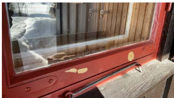
Vedlikeholdsbehov og sprekkdannelse i kitt
