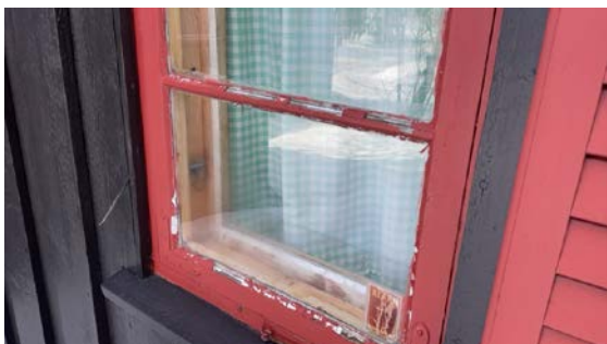
Må påregnes vedlikehold/utskifting
