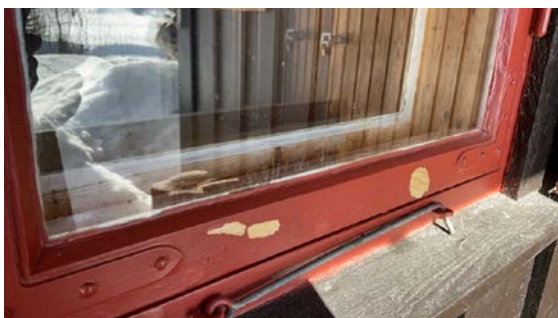
Vedlikeholdsbehov og sprekkdannelse i kitt
