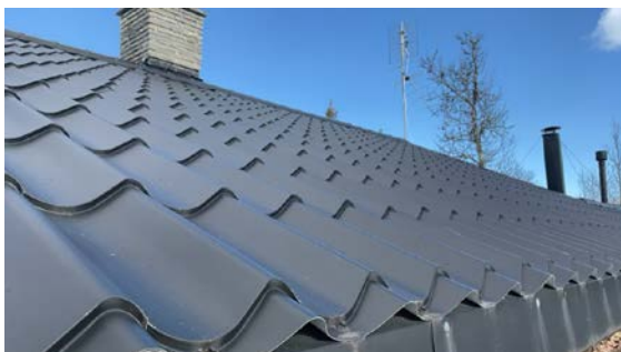
Ansees med restlevetid
