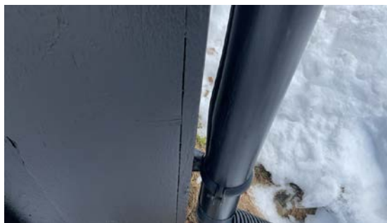
Frostspreng på nedløp
