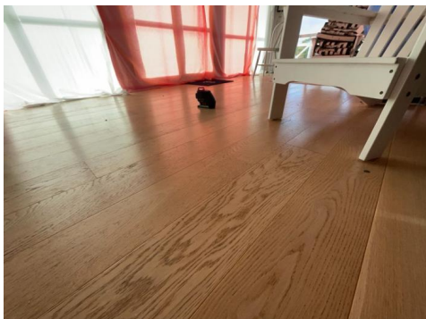
Høydeforskjeller kontrollert i spisestue.
