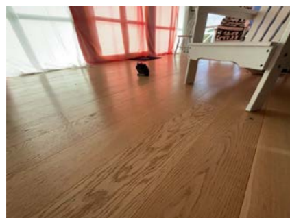
Høydeforskjeller kontrollert i spisestue.
