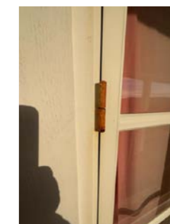
Utsnitt terrassedør, rust på hengsler.
