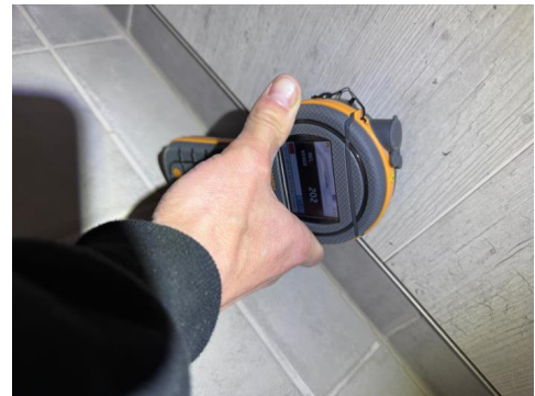
Utført fuktsøk med et protimeter MMS2. Det registreres forhøyde fuktverdier i nedre del av baderomsplater.
