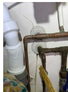
Fuktskadet gipsvegg fra tilstøtende rom
