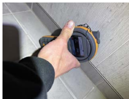
Utført fuktsøk med et protimeter MMS2. Det registreres forhøyde fuktverdier i nedre del av baderomsplater.
