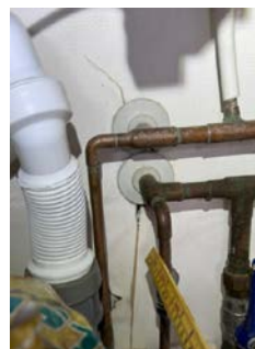
Fuktskadet gipsvegg fra tilstøtende rom
