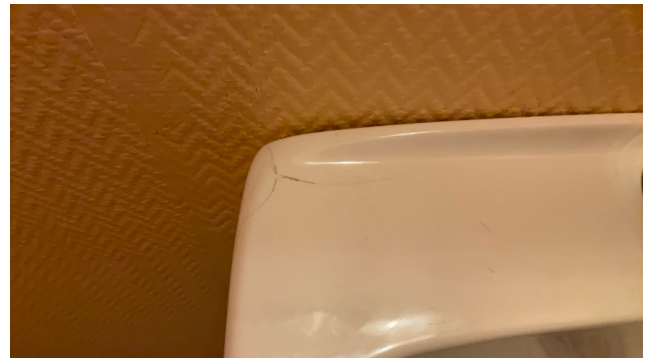
Sprekk i servant.
