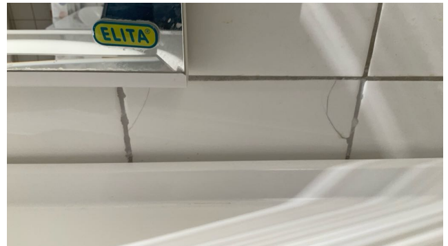
Sprekker i veggflis.
