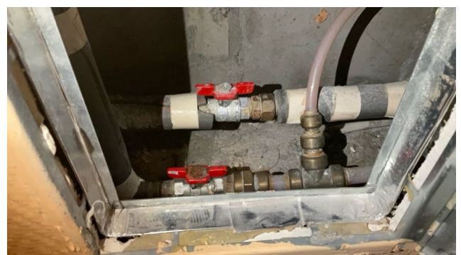
Stoppekraner bak luke på toalettet.
