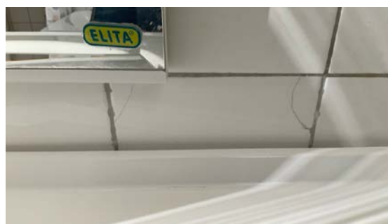
Sprekker i veggflis.
