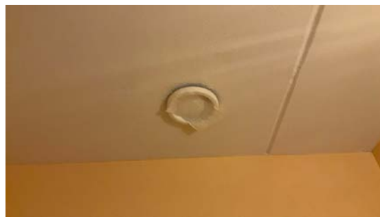
Test av avtrekk. Papiret henger.
