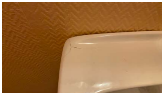
Sprekk i servant.
