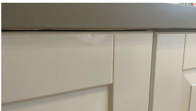
Skade i kjøkkenfront.
