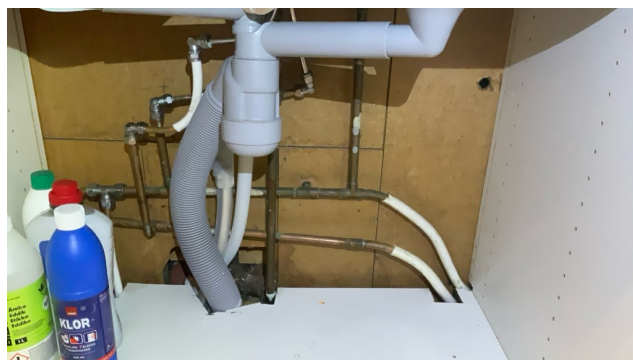
Vannledninger av kobber.
