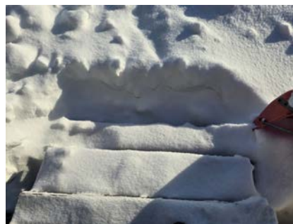
Begrenset vurdert utvendig trapp.
