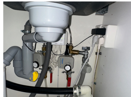
Røropplegg i kjøkkenbenk med Waterguard
