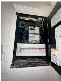
Sikringsskap med automatsikringer.
