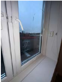
Sprekk i glass i vindu på soverom
