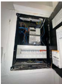
Sikringsskap med automatsikringer.
