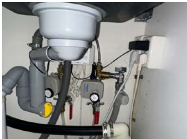
Rørøpplagg i kjøkkenbenk med Waterguard
